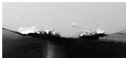
4. 〈修復前〉鉄部分からの腐蝕
