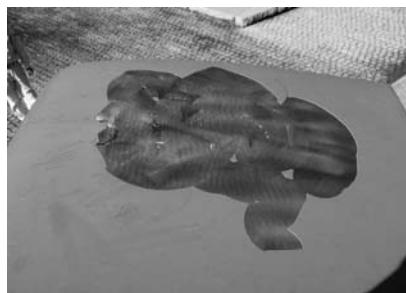
1. 〈修復前〉天井面の広範囲の剥落と腐蝕箇所
